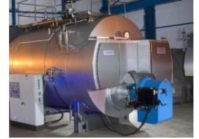
Gia Nhiệt Nước Cấp Cho Nồi Hơi
