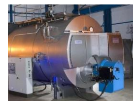
Pre-Riscaldamento Boyler ad Acqua
